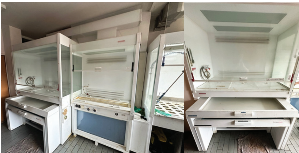
Рис. 1. Приміщення для травлення (травильні шафи)
